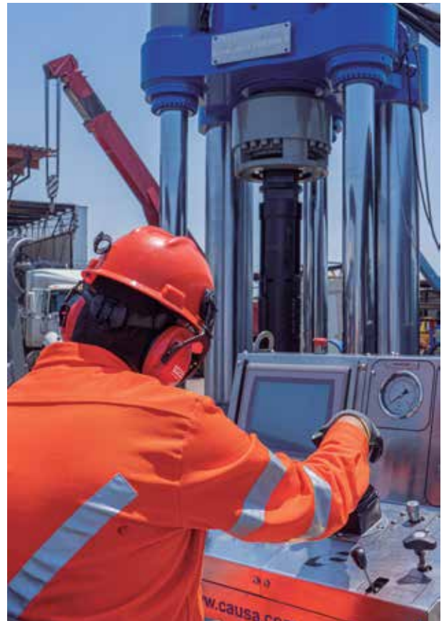
Operación del equipo y sistema de control
