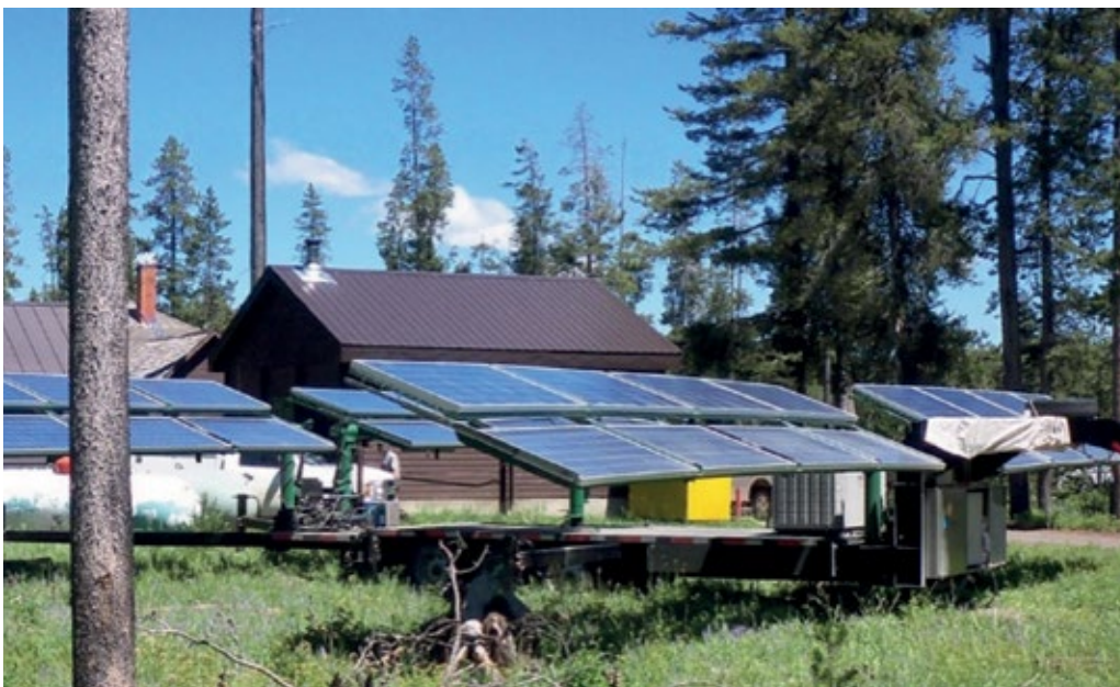
La matriz de paneles fotovoltaicos detrás de la estación del guardabosques de Bechler proporciona el 98% de la electricidad necesaria.
